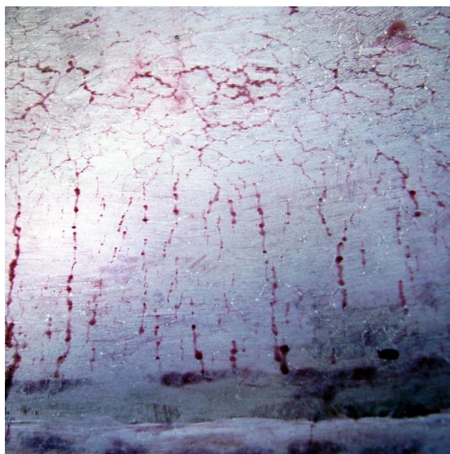
Рисунок 4. Трещины на внутренней поверхности распределительных камер теплообменников (цветная дефектоскопия)
