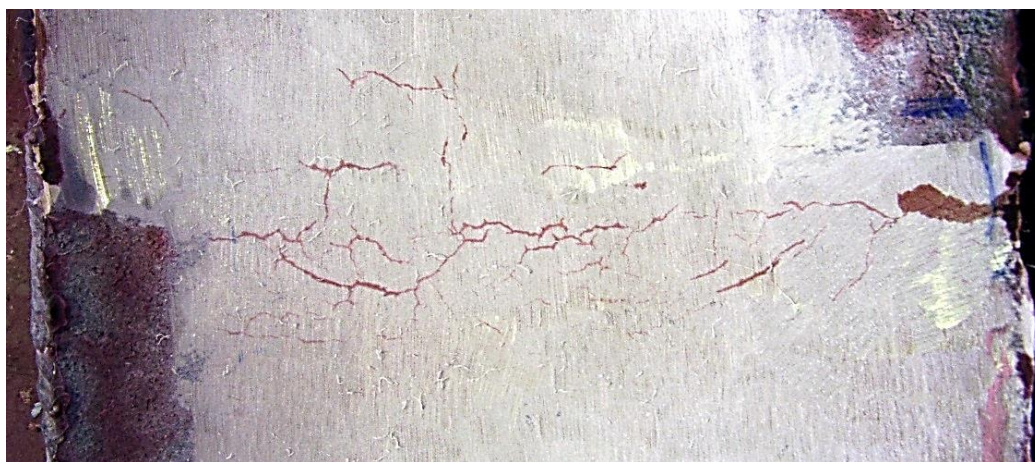
Рисунок 3. Трещины на внутренней поверхности шлемовой трубы (поверхность зачищена после цветной дефектоскопии)
