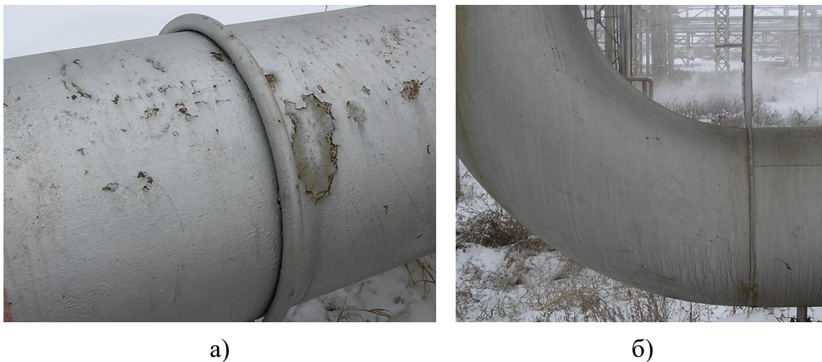
Рисунок 2. Состояние наружной поверхности трубопровода сырого газа (а), товарного газа (б)
