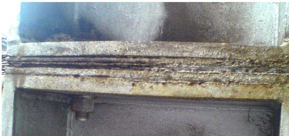
Рисунок 5. Атмосферная коррозия регулировочных листов теплообменников «амин – амин»
