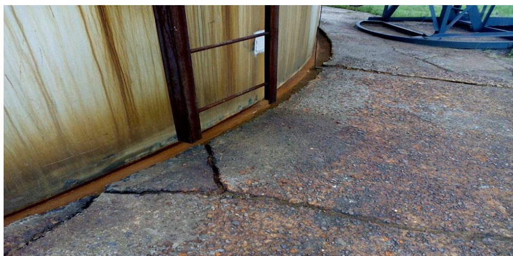
Рисунок 2. Трещины в отмостке резервуара
