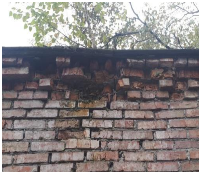
Рисунок 2. Разрушение карниза здания и выветривание деструктированного раствора из швов кирпичной кладки на глубину до 50 мм
