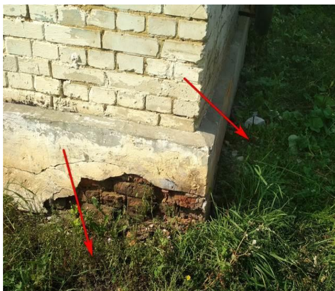
Рисунок 1. Отсутствие отмостки, приведшее к замачиванию и разрушению облицовки и кирпичной кладки цоколя здания
