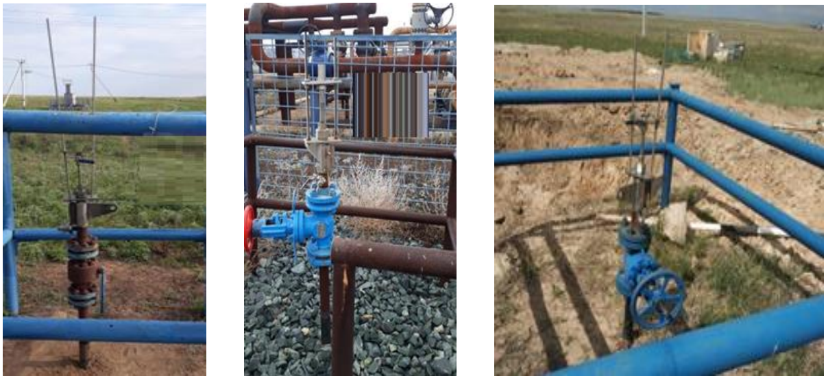
Рисунок 1. Установка узлов контроля коррозии (УКК)
