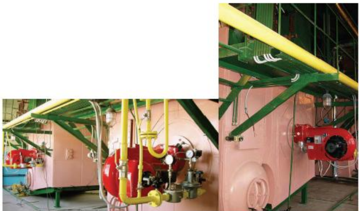
Рисунок 2. Установка горелки G9 на котле ДЕ-4
