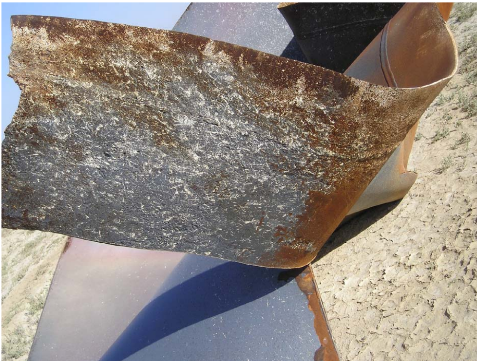
Рисунок 3. Коррозия на внешней поверхности трубы. Отчетливо видна область перехода участка трубы с отслоившейся изоляцией
