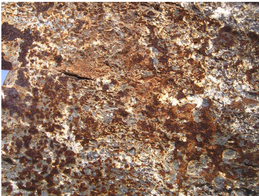
Рисунок 2. Коррозия на внешней поверхности трубы
