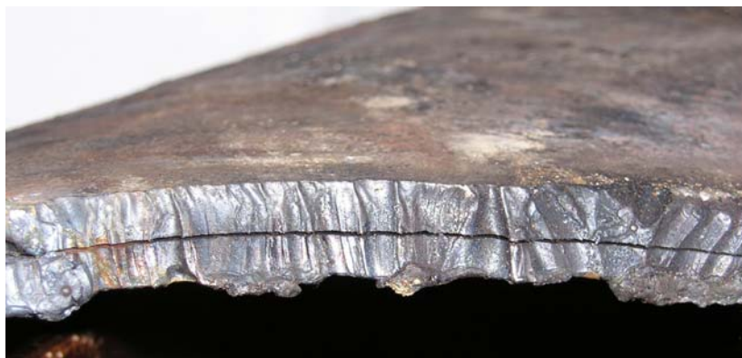
Рисунок 1. Вид расслоения стенки трубы
