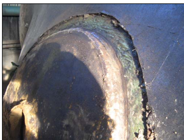
Рисунок 5. Состояние изоляционного покрытия на вантузном узле
