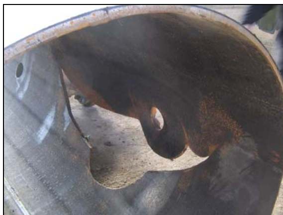
Рисунок 2. Вид трещины изнутри трубы
