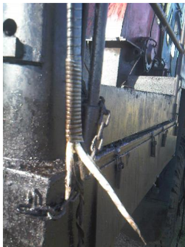
Рисунок 2. Обрыв кабеля на скважине № 797
