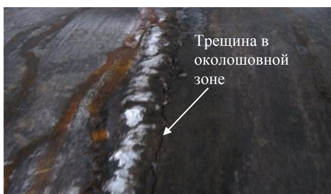
Рисунок 1. Трещина в околошовной зоне сварного соединения корпуса насоса
