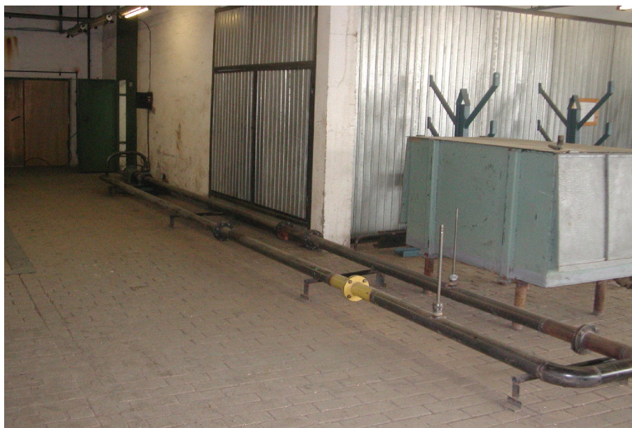
Рисунок 1. Фотография станда для изучения скорости коррозии участка трубопровода
